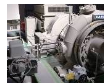
遠隔監視システムが導入されている 長谷峠土地改良区の長谷峠井路発電所
