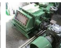
緒方井路土地改良区で誕生した小水力発電所
