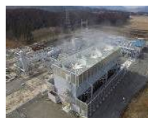
涌土バイナリー発電所 (出光大分地熱(株))
