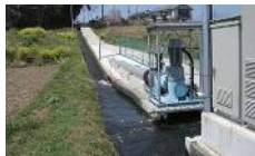
城原井路発電所(竹田市)(発電出力:25kW)
