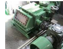
緒方井路土改良区/緑生小水力発電所
