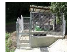
宮ヶ瀬小水力発電所
