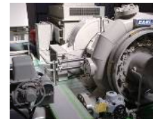
遠隔監視システムが導入されている長谷緒土改良区長谷緒井路発電所
