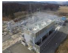
通上バイナリー発電所 (出光大分地熱(株))
